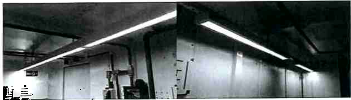
Figura 7 - Sistema de iluminação
