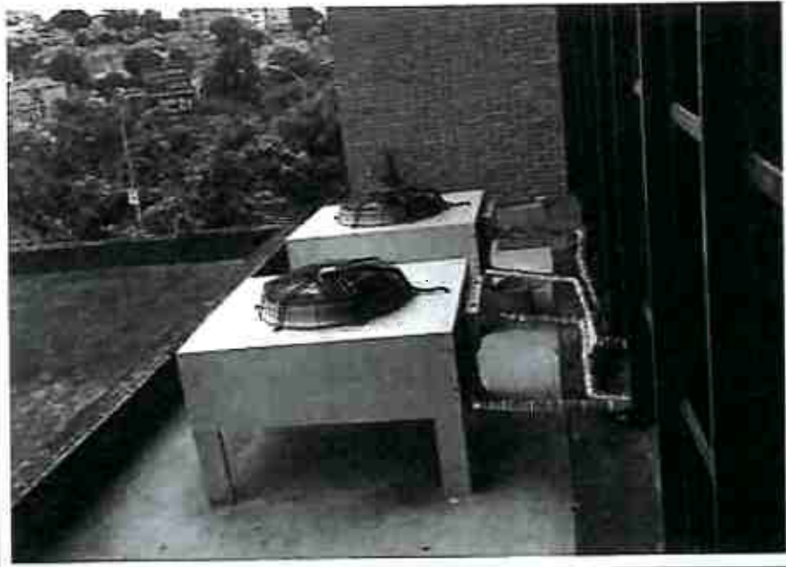
Figura 12 – Condensadores e evaporadoras/ ar-condicionado
